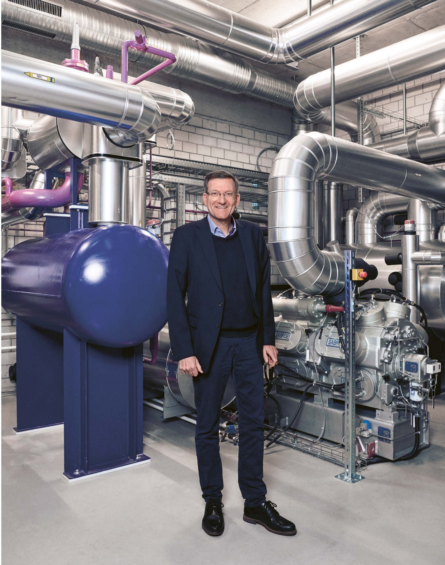
Toni Sigrist in einem der Maschinenräume des Energieverbundes Neuhausen am Rheinflall. Sigrist's Firma Walter Wettstein AG hat die Wärmepumpenanlagen für die Fernwärmeversorgung gebaut.
